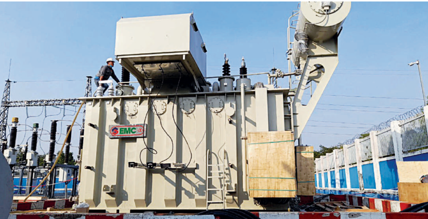
TRẠM TRUYỀN TẢI 63MVA 110KV THỦ ĐỨC ĐÔNG - TỔNG CÔNG TY ĐIỆN LỰC HCM Thu Duc Dong 63MVA 110kV transmission station - HCM Power Corporation
