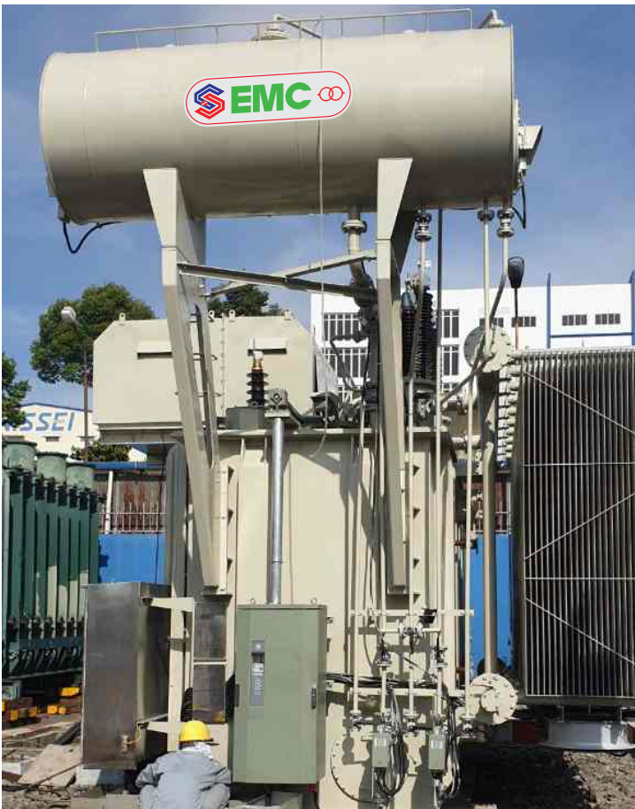
MUA SẴM 2 TRẠM 63MVA-110/35/22KV DỰ PHÒNG - TỔNG CÔNG TY ĐIỆN LỰC MIỀN BẮC Procurement of 2 backup stations 63MVA-110/35/22kV - Northern Power Corporation
