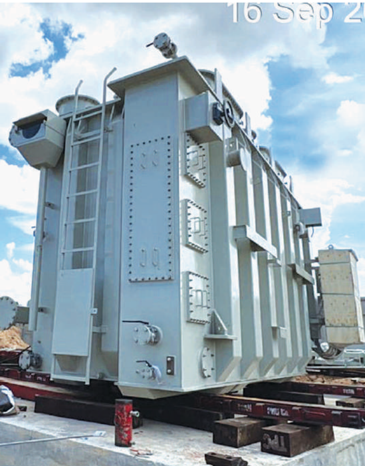
TRẠM TRUYỀN TẢI 63MVA 110KV HÀ TỈNH TỔNG CÔNG TY ĐIỆN LỰC MIỀN BẮC Ha Tinh 63MVA 110kV transmission station, Northern Power Corporation
