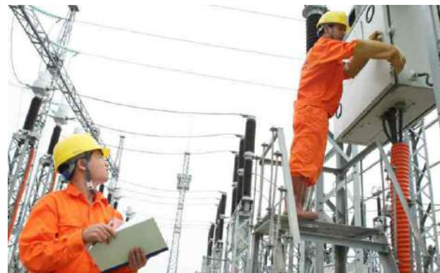
DỰ ÁN LƯỚI ĐIỆN TẬP ĐOÀN ĐIỆN LỰC VIỆT NAM (EVN) Vietnam Electric Corporation Power Grid Project
